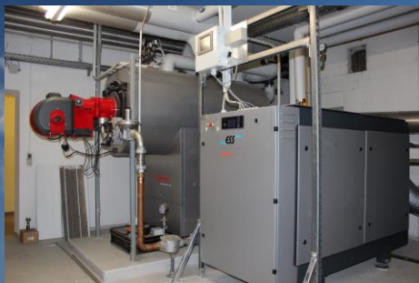
Anne-Frank-Schule Rastatt BHKW
